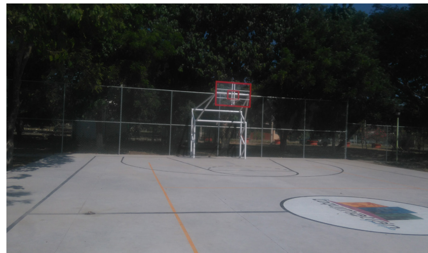
Rehabilitación de cancha de usos múltiples en la localidad de Los Limones.
