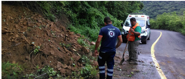
Atención en derrumbes de carreteras municipales para seguridad de la población.
